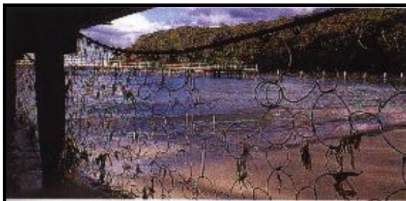
Photo 3 : Filet métallique de protection en mauvais état.
